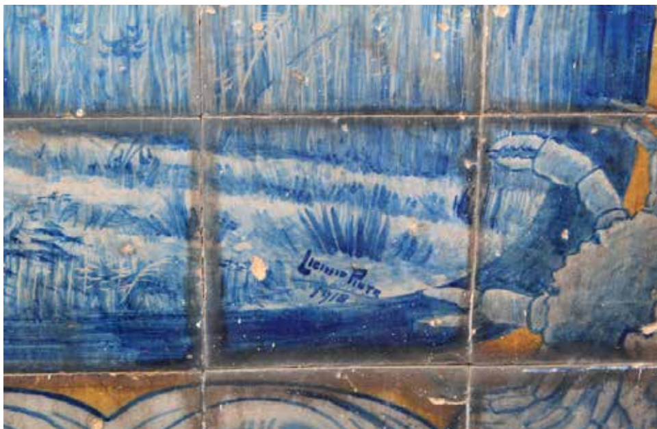
Figura 19 - Depósitos de poluentes atmosféricos registados no painel N.º 10 da fachada Poente, antes da intervenção.
