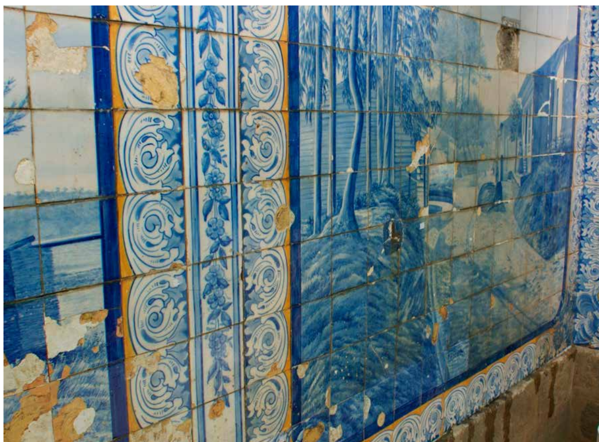
Figura 18 · Lacunas de vidro, preenchimentos inadequados e depósitos. Painéis 3 e 4 da fachada poente, antes da intervenção.
