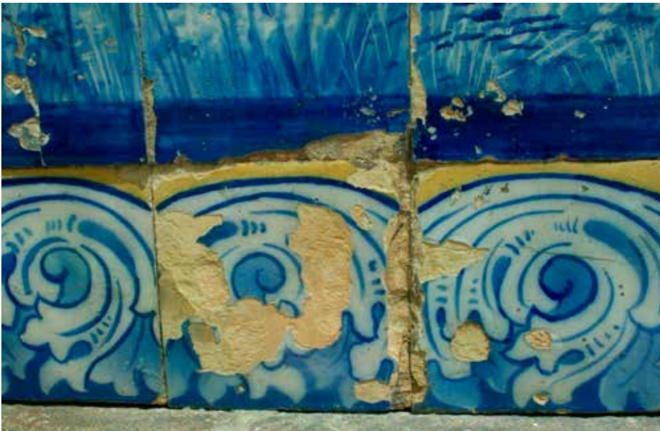
Figura 15 - Exemplo de áreas substituídas por reproduções devido ao mau estado de conservação dos azulejos.
