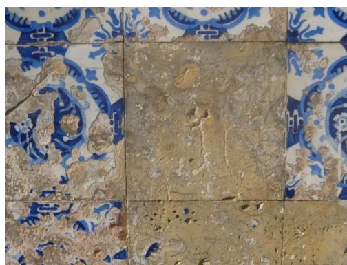
Figura 14 - Desaparecimento do vidrado dos azulejos (Rua de São Roque nº41 – Aveiro)
