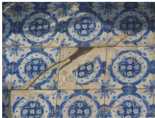
Figura 13 – Fissuração do azulejo (Rua de São Roque nº41 – Aveiro)
