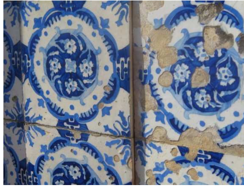
Figura 12 – Empolamento do azulejo relativamente ao suporte (Rua dos Marnotos – Aveiro)
