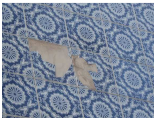
Figura 15 - Desprendimento do vidrado dos azulejos (Rua de São Roque nº41 – Aveiro)
