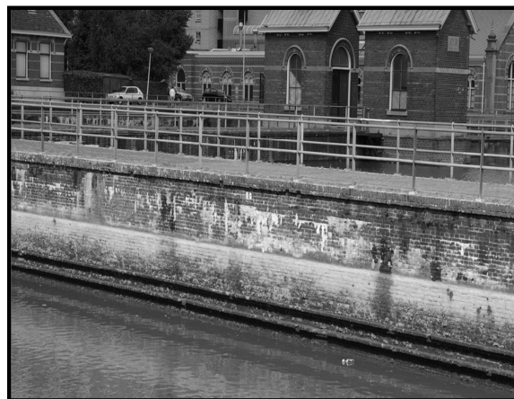
Figura 31. Concreções à superfície de um muro de tijolo junto de um canal de água (LUBELLI, 2011)
