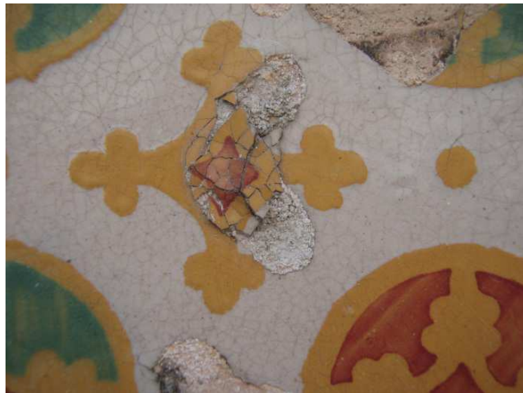
Figura 27. Eflorescências em azulejo
