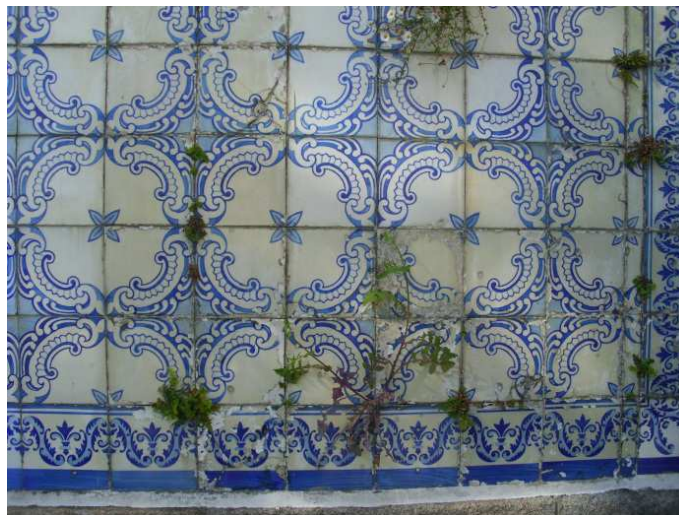
Figura 28. Crescimento de vegetação em fachada azulejar
