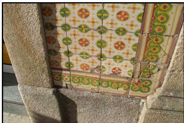
Figura 23. Fraturas em azulejos com separação de fragmentos
