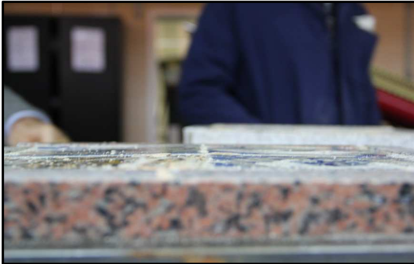
Figura 77. Pormenor do empolamento detetado no sistema horizontal dois
