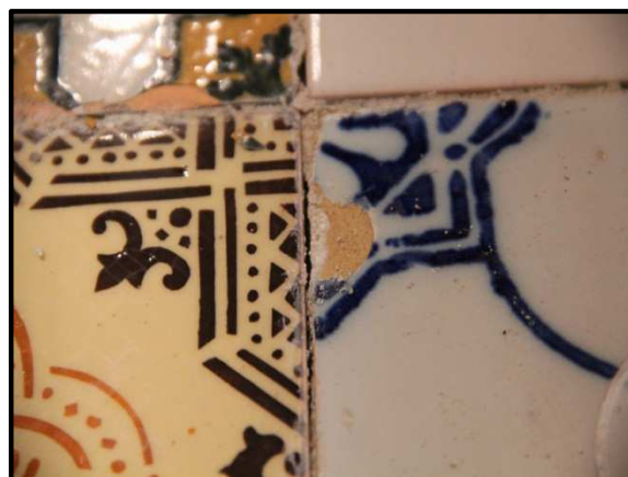
Figura 84. Pormenor da remoção de argamassa de junta no sistema três após ensaio de envelhecimento
