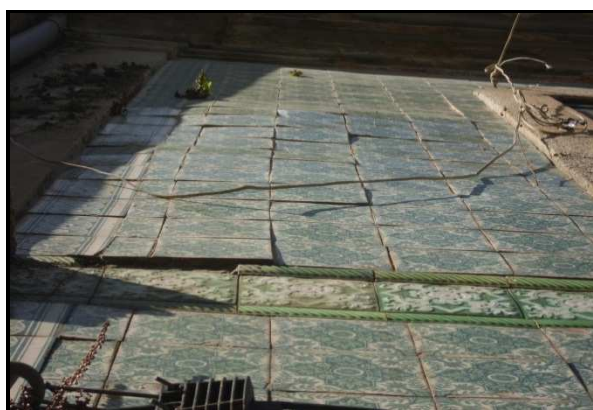
Figura 21. Destacamento e empolamento de azulejos em fachada
