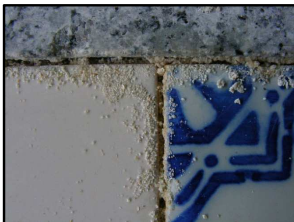
Figura 83. Pormenor da remoção de argamassa de junta no sistema um após ensaio de envelhecimento
