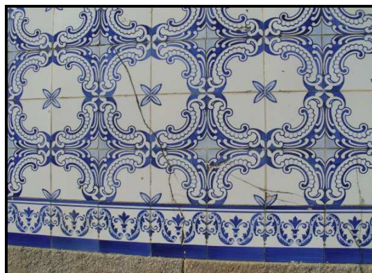
Figura 24. Fraturas de azulejos em fachada azulejar
