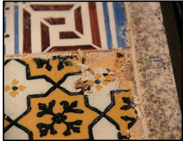
Figura 80. Pormenor de destacamento de vidrado no sistema horizontal três
