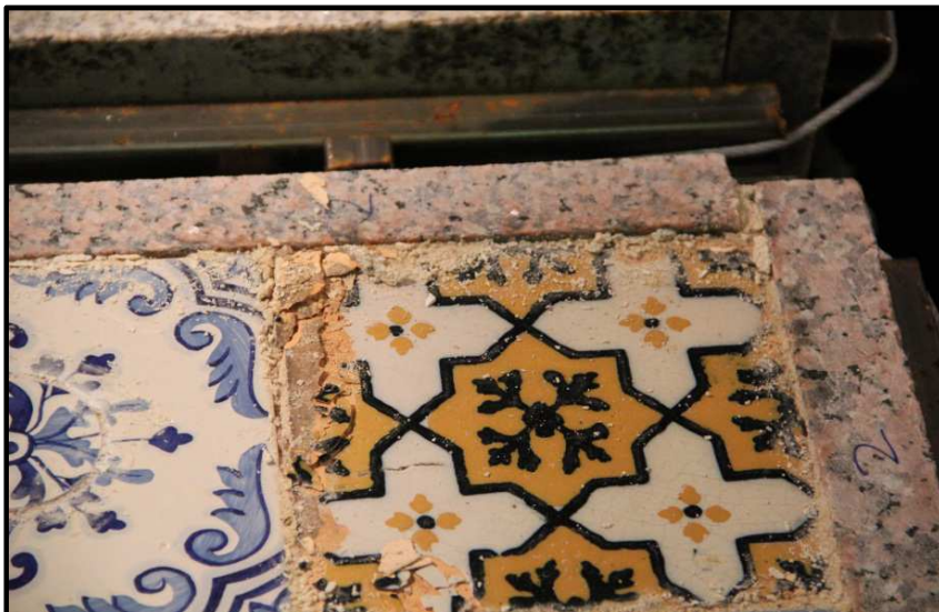
Figura 78. Pormenor de destacamento e esmagamento de vidro ao nível do bordo do azulejo original
