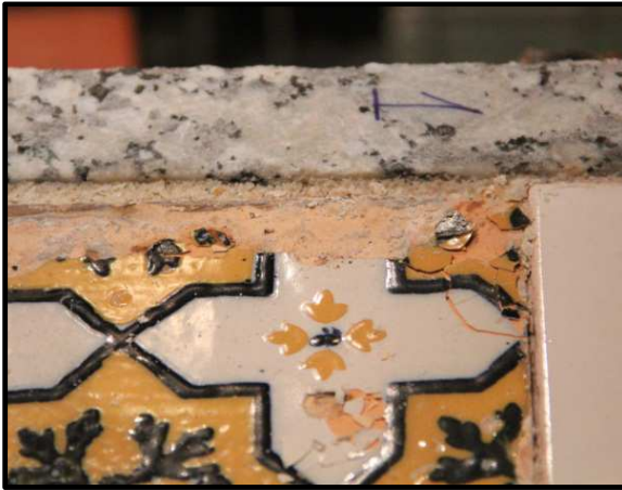
Figura 79. Pormenor de destacamento de vidrado no sistema horizontal um
