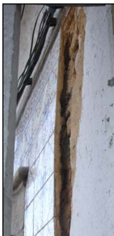
Fig. 20 – Caso de descolamento de parte de painel
