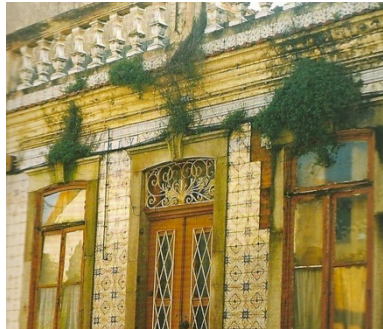
Fig 45 Casos de descolamento, eflorescências, factores antrópicos e biodeterioração
